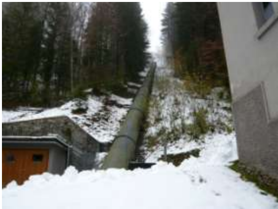
3) Wasserdruckrohr beim EKZ Waldhalden.
