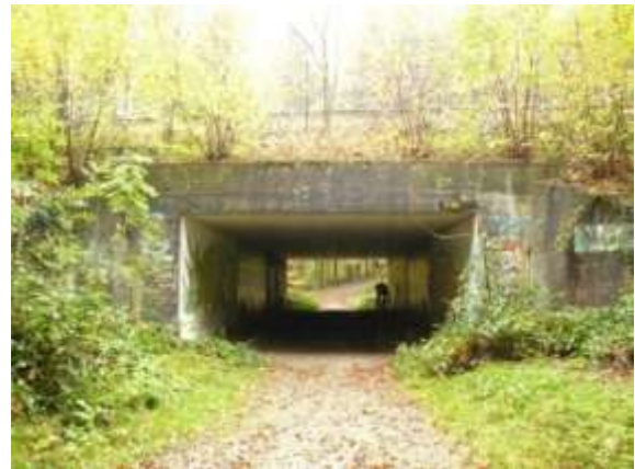
9) Zwangswechsel A52: Unterführung Waldweg ist zu lang zu schmal und vor allem zu wenig hoch und somit für Huftiere ungeeignet.
