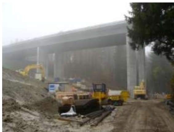
6) Zwangswechsel unter der Autobahnbrücke A1 zwischen Breitrain und Hintere Setzi.
